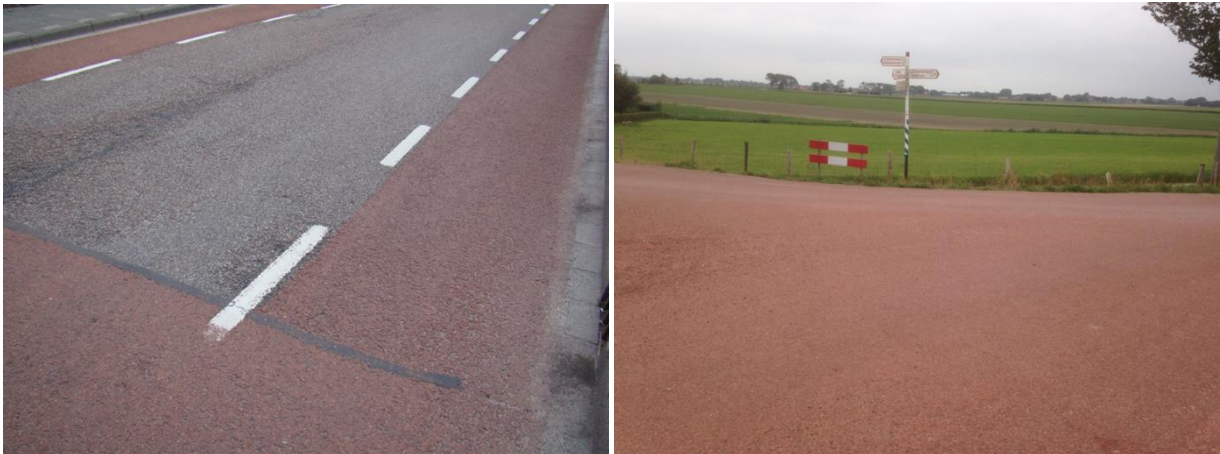
Afbeelding 5 en 6: Typisch schadebeeld van rood asfalt met niet gemodificeerd kleurloos bindmiddel. Datum van aanleg voor de situatie links was rond 2004. Hier was in 2019 duidelijk rafeling zichtbaar, maar dit gold ook voor het tussenliggende (zwarte) asfalt.
