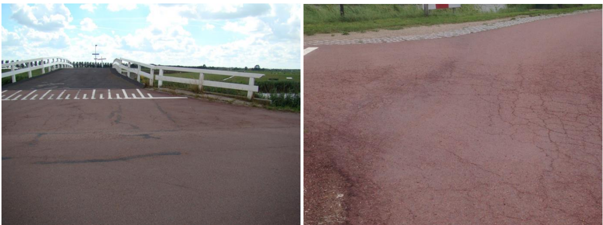
Afbeelding 3 en 4: Typisch schadebeeld van rood asfalt met zwarte bitumen. Exacte datum van aanleg is niet bekend, maar vermoedelijk minder dan 10 jaar geleden.
